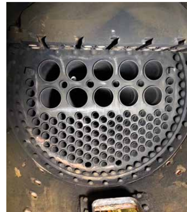
Vue de l'intérieur de la chaudière à vapeur : cinq tubes bouilleurs doivent être remplacés.
